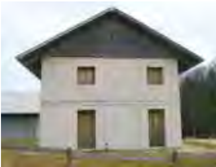
Exposition West, unbehandelte Stülpschalung, Alterung nach 62 Monaten: Die Verfärbung ist relativ gleichmässig.
