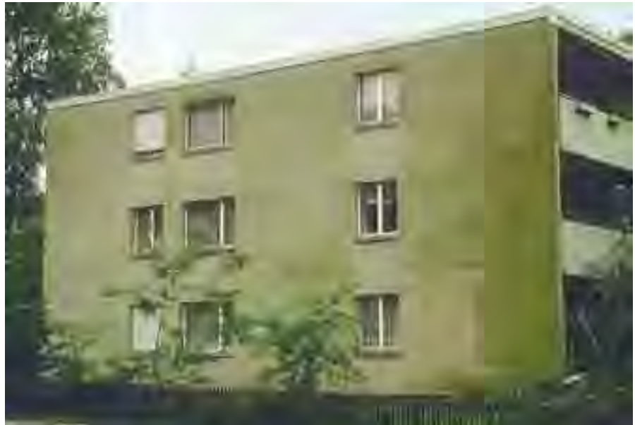
Durch konstruktive Massnahmen liesse sich der Einsatz von Bioziden reduzieren. Doch häufig fehlen sie wie bei dieser veralgten Nordseite ohne Dachüberstand.
