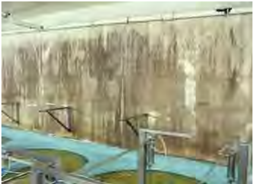
Auch Innenräume können von Pilzen befallen sein, z. B. wie hier bei Belastung durch Spritzwasser.
