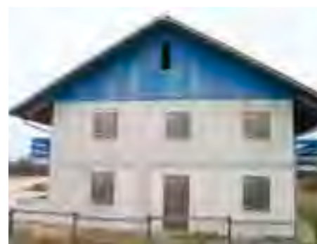
Exposition West, deckend blaue Beschichtung, Alterung nach 62 Monaten: Die Beschichtung ist bereits stark abgewittert, das Erscheinungsbild ist sehr ungleichmässig.
